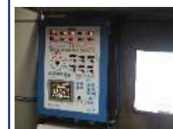
環境制御システム
