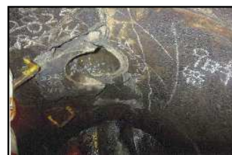
接続部の破損(新木場)
