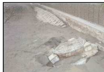
液状化による浮上(新木場)
