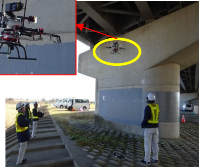
ドローンを活用した写真撮影により 橋梁の損傷を確認
