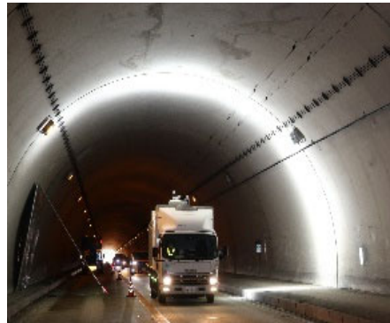
レーザー計測によりトンネルの 背面空洞や損傷を確認
